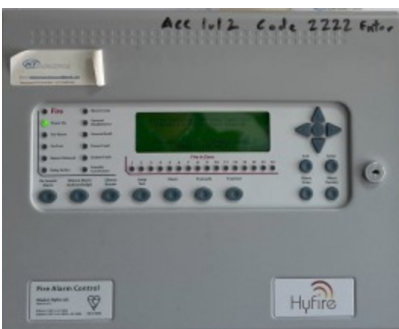
Flats Fire Alarm Panel.
