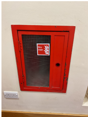
Dry Riser Outlet.
