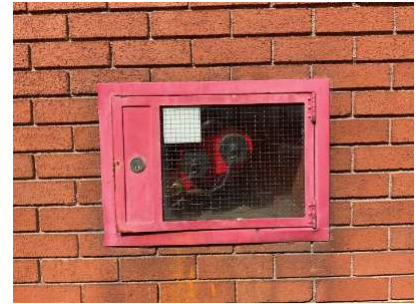
Dry Riser Inlet.
